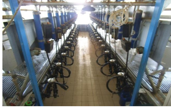
Süt Sağım Tesisi
